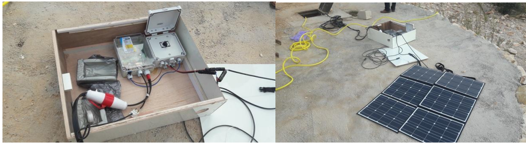
صورة: وحدة طاقة شمسية متنقلة لتشغيل مضخة مياه تم تركيبها على بئر جمع مياه أمطار.
