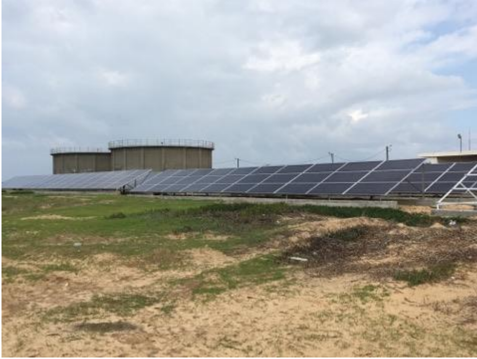
وحدة الطاقة الشمسية التي نفذها المركز لتشغيل محطة معالجة المياه العادمة في محافظة رفح
