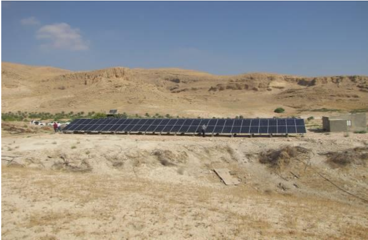
صورة توضح الخلايا الشمسية المستخدمة لضخ المياه على بئر خزوق موسى
